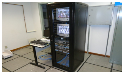
Sala de controle do CFTV
